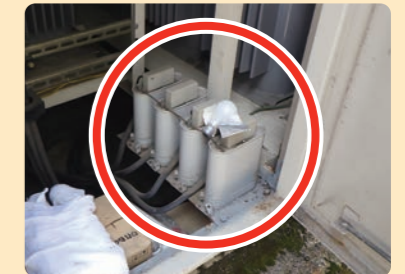
キュービクル内に残置された廃コンデンサー
