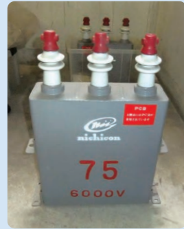
電力用コンデンサー
