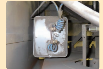
電気溶接機の内部に取り付けられた低圧コンデンサー
