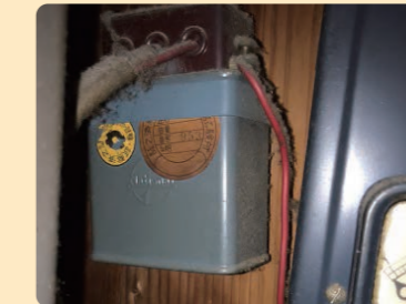
配電盤に設置された低圧コンデンサー
